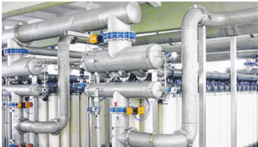
Die Sanierung des Wasserwerkes Haspe – hier die Ultrafiltrationsanlage – steht vor dem Abschluss.
